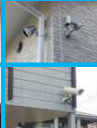
【一般住宅設置例】
